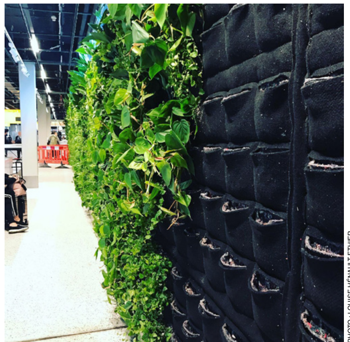
Figure 21 – Mur végétalisé en construction utilisant un terreau dans des pochettes de géotextile à l'Aéroport de Schiphol.
