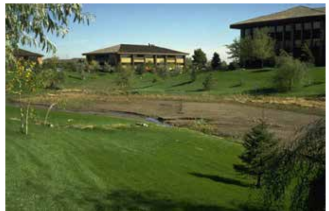
Figure 11.3 Accumulation de sédiments à l'intérieur d'un bassin sec sans prétraitement.
